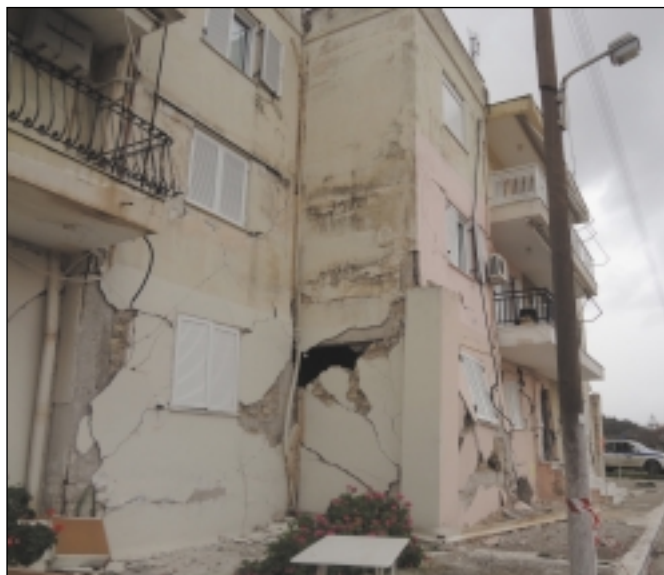
Εργατικές κατοικίες στο Ληξούρι (σεισμός 3-2-14)
