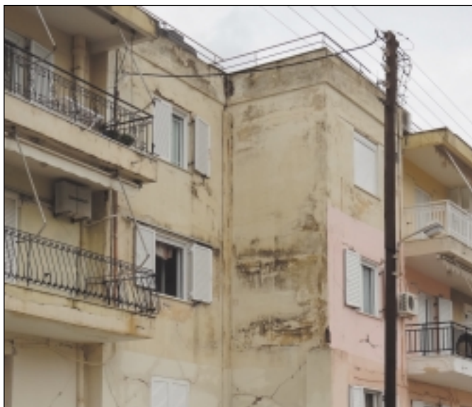
Εργατικές κατοικίες στο Ληξούρι (σεισμός 26-1-14)
